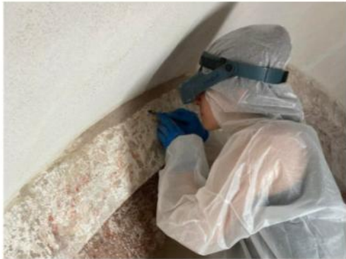
Le travail de restauration des peintures a nécessité d'enlever les nombreuses couches d'enduit qui les recou-
