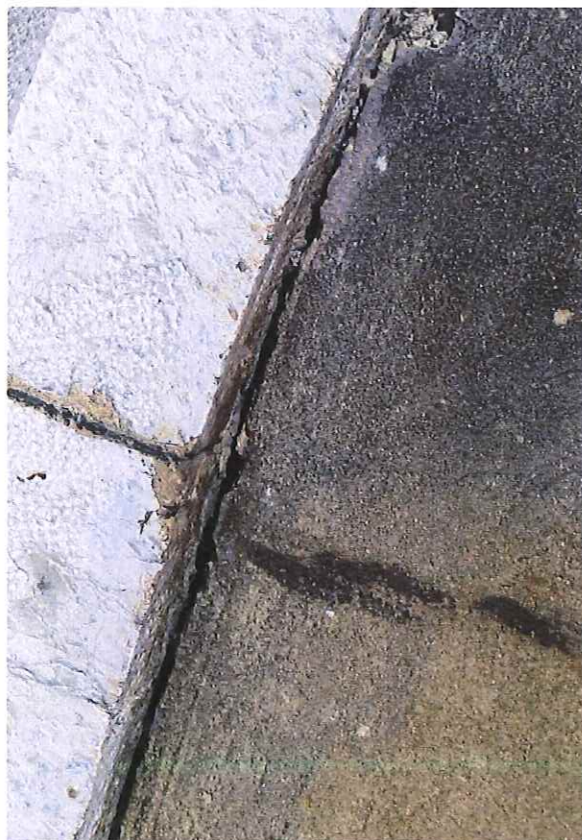
Fissure sur le côté gauche
