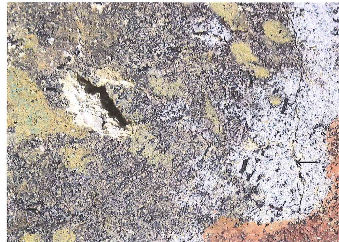
Exemple de microfissures
