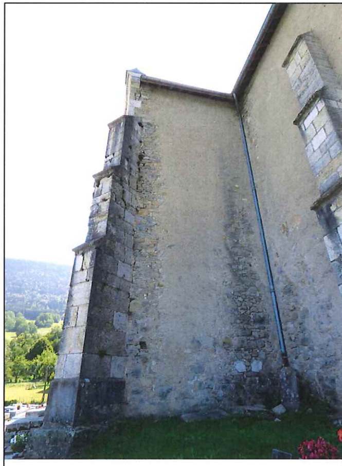
DEGRADATIONS DE L'ENDUIT
