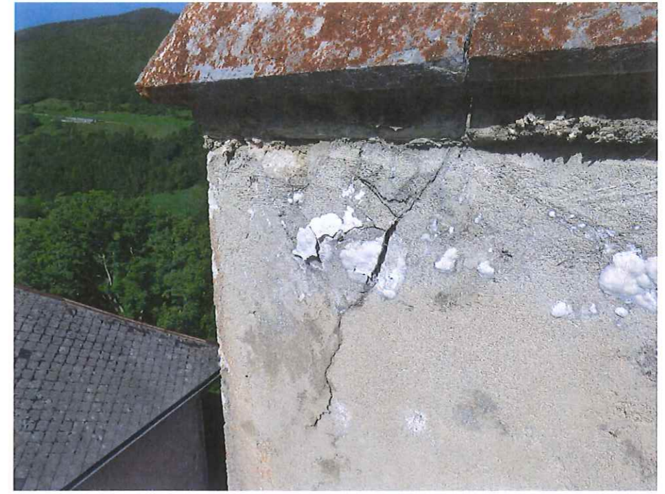
EFFLORESCENCES DANS LES MACIONNERIES DU CLOCHER
