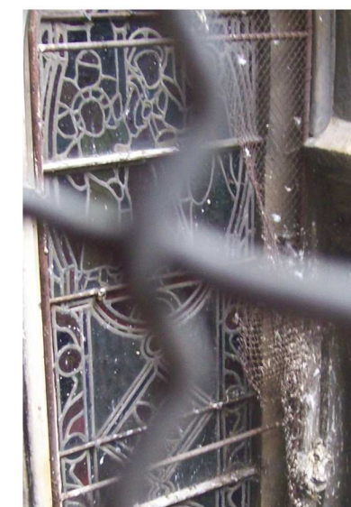
Grillages dégradés, manquants ou encombrés par les déjections animales, sur armature en bon état général
